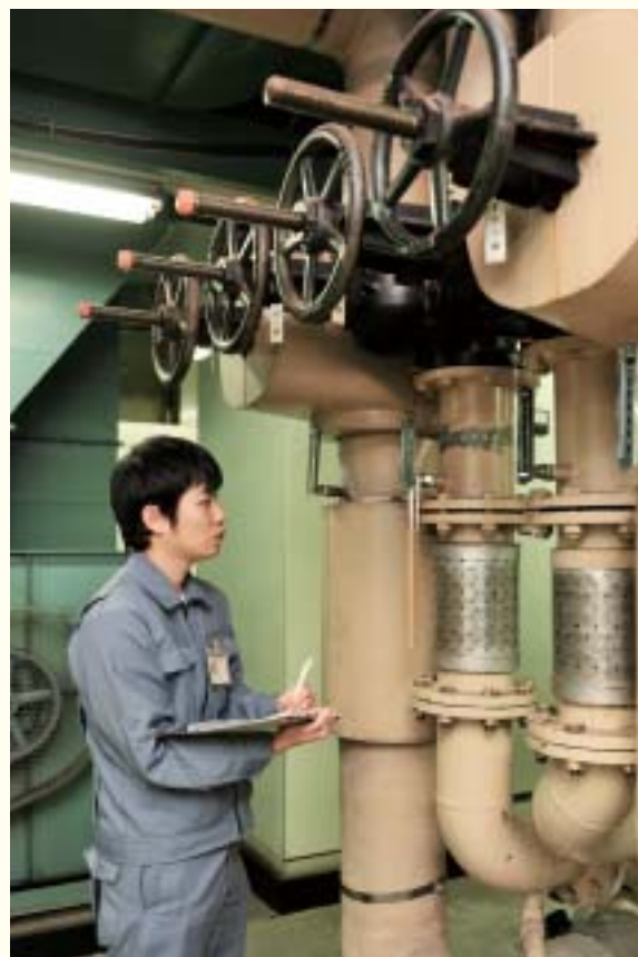
ターボ冷凍機保守管理
